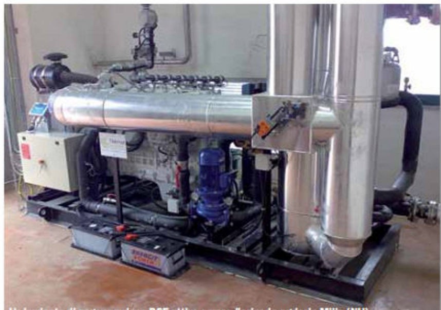
Un impianto di cogenerazione DSF attivo presso l'azienda agricola Milia (NU)
